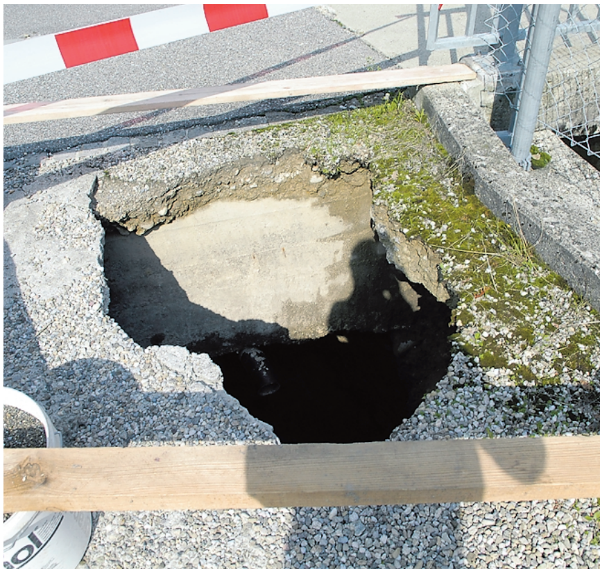
Hergiswil. Ein Loch mitten im Asphalt. Die Wiggerbrücke bei der Dorfbäckerei Thalman ist seitlich unterspült worden. Foto Klaus Marti
